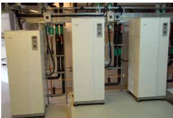
På Sportflygargatan i Skarpnäck har Stockholmshem ca 1000 lägenheter. Här har HP Rör installerat NIBE F1330 i tio centraler. Centralen på bilden är försedd med 3 x NIBE F1330 på vardera 40 kW. Men man planerar att installera ytterligare en värmepump på 30 eller 40 kW.
