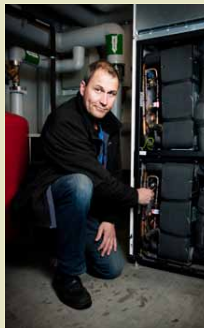
De två kompressorerna syns tydligt när man tar loss skyddsplåten. Jonas Linder från Villavärmeteknik i Sigtuna.
